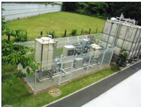
写真1. 分散型水処理・給水システム
